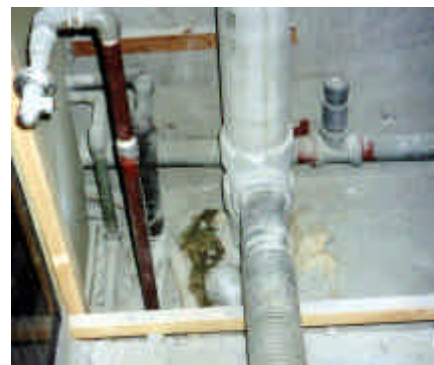
図-4 改修前（汚水立て管） 手前：汚水横枝管 奥：台所流し横枝管 トイレ壁裏の余裕のあるPS
