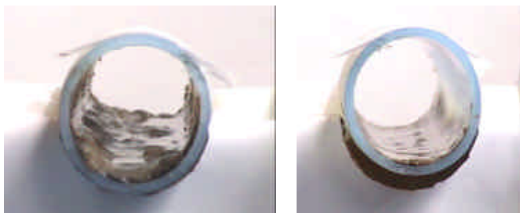
図-3 入居 1 年後の専有部排水横枝管内付着状況 (管径：50mm)
