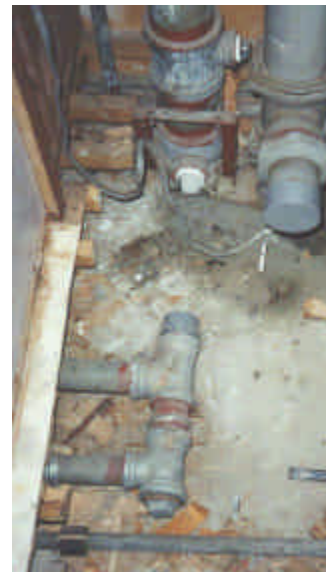
図-1 雑排水立て管と横枝管 (配管用炭素鋼鋼管とねじ込み式排水管継手が使用されている。ねじ部からの漏水が排水管改修の動機付けとなった。)
